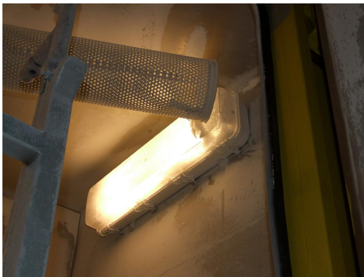
Fot. 1 Oprawa oświetleniowa w komorze pyłowej
